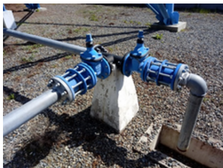
Parte del sistema de distribución.
