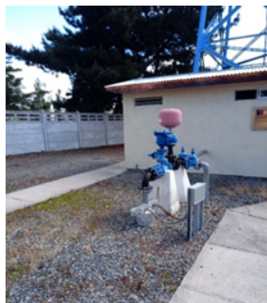
Bomba de agua.
