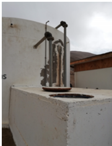
Construcciones asociadas al colector de agua
