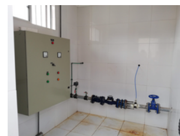
Panel eléctrico y cañerías de control del flujo de agua.
