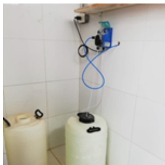
Parte del equipamiento del proyecto, relacionado con la cloración de agua.
