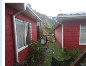
Derrumbe cerro y destrucción de pandereta
