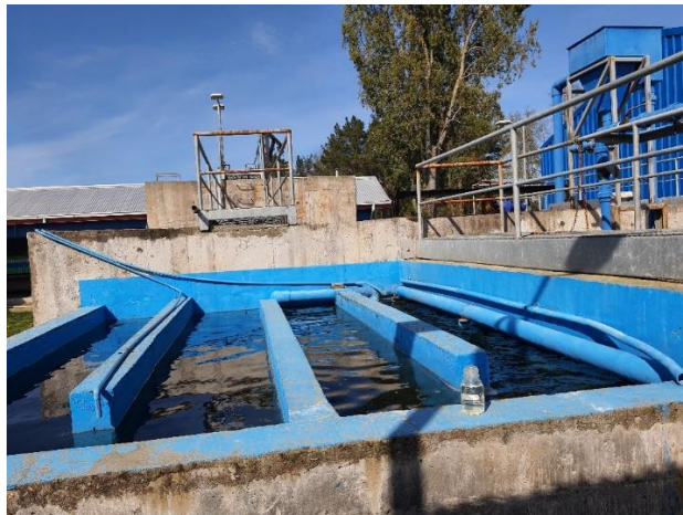
Estanques de tratamiento
