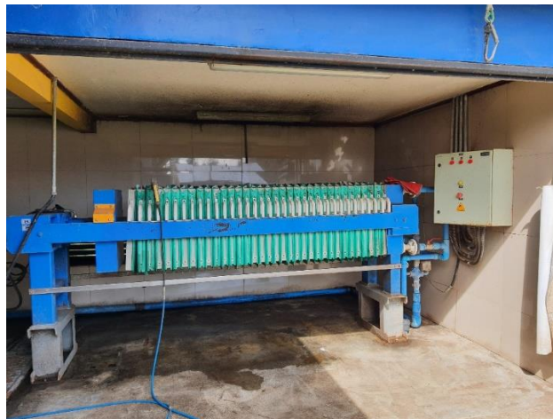
Equipo de prensado de lodos.
