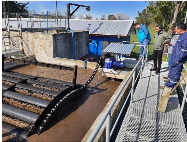
Piscina de aireación y tratamiento.
