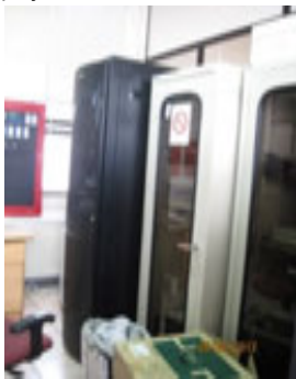
Fotografía N° 6: Sala servidor del Complejo
