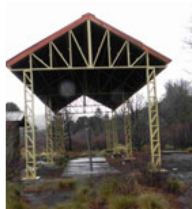
Fotografía N° 7: Planta tratamiento aguas residuales
