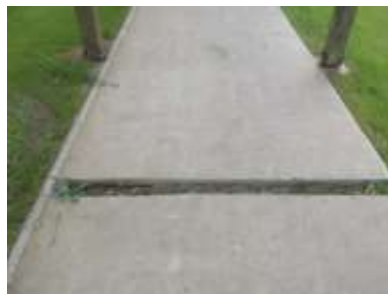
Pisos hormigón, cuidado con juntas de dilatación.
