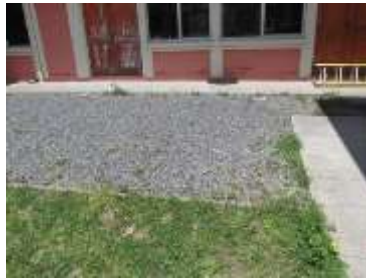
Pavimento Inadecuado para Circulación
