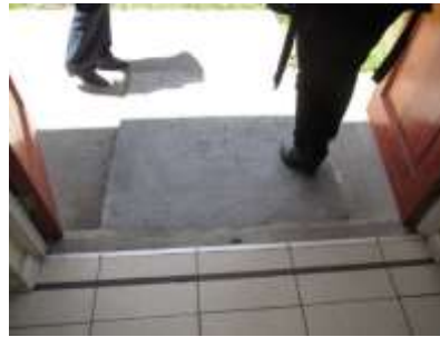
Rampa hecha In Situ. Fuera de Normativa.
