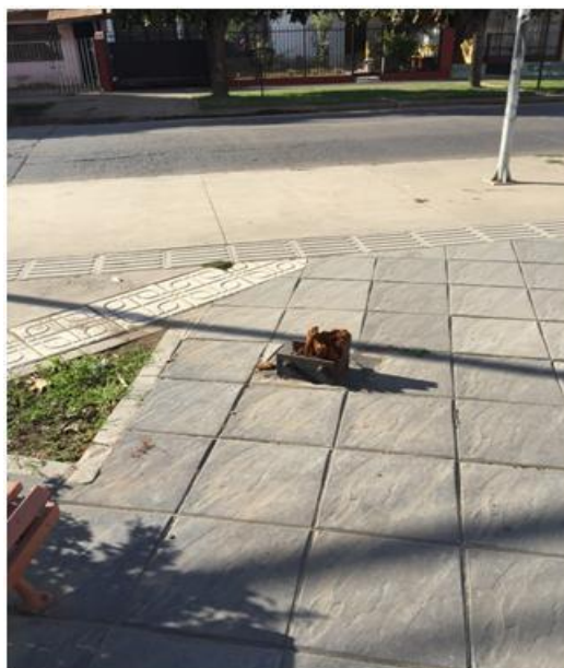
Desprendimiento de tótems
