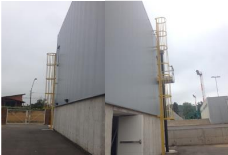
Foto N°17 Fotografías, Cabina de Audio e Iluminación, Polideportivo de Villa Alemana
